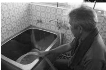
ポンプで温泉を入れています
