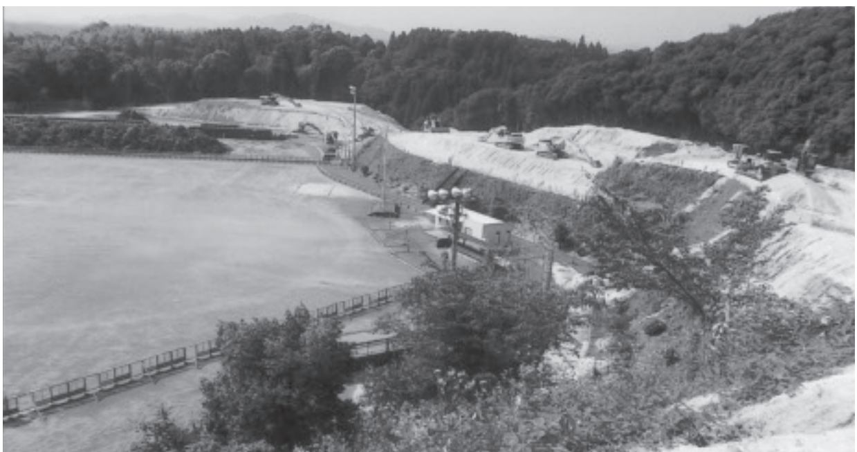
菊水区域小中併設型校造成工事現場(番城グラウンド周辺)
