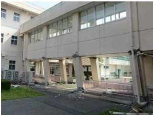
図 渡り廊下の倒壊（校舎）
