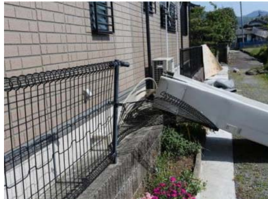
図 給湯施設の転倒
