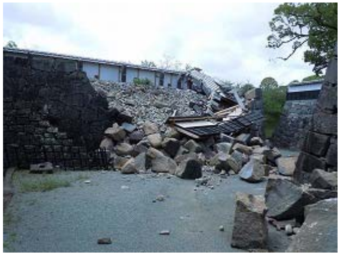
図 平成28年熊本地震の被害 熊本城 被災後の馬具櫓そばの枅形
