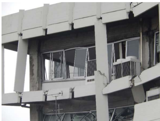
図 庁舎棟の局部崩壊（宇土市）
