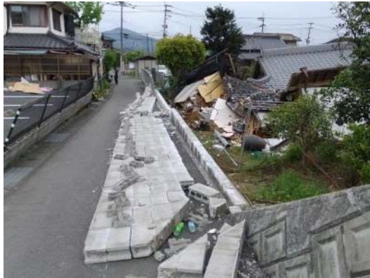
図 ブロック塀の倒壊
