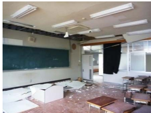
図 写真 天井の脱落（校舎）
