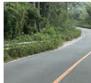
車道にはみ出した雑草
