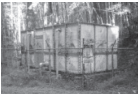
町道西光寺中林線の頂上付近に設置されている受水槽
