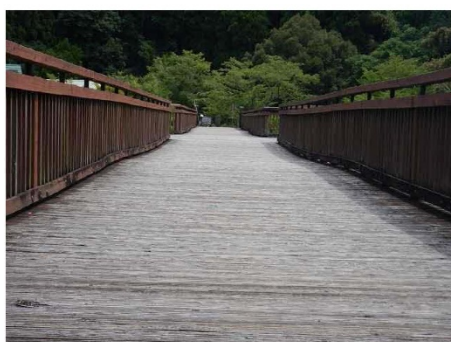
若園橋橋面のたわみの状況 (R4. 7. 8 撮影)
