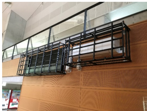
アリーナの空調設備（入口付近）
