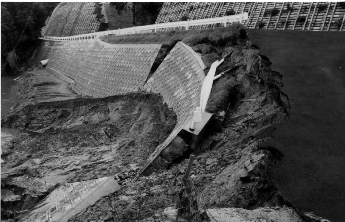
地盤が緩み決壊した道路（県道竈門・菰田・山鹿線）
